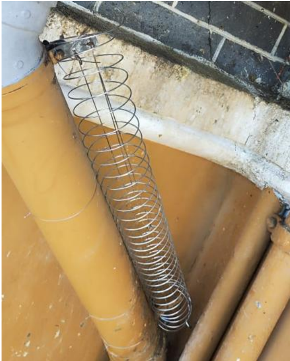
Figura 29 - Modelo de mola instalada no prédio da FAP.
