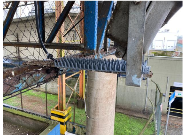
Figura 26 - Modelo de espícula instalada no Gate 14.
