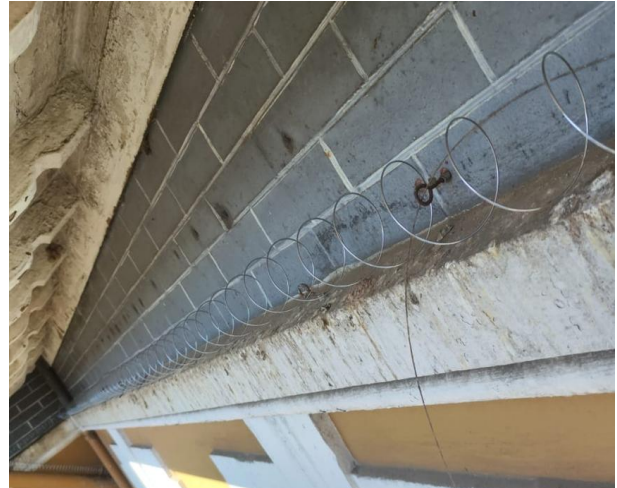
Figura 30 - Modelo de mola instalada no prédio da FAP.
